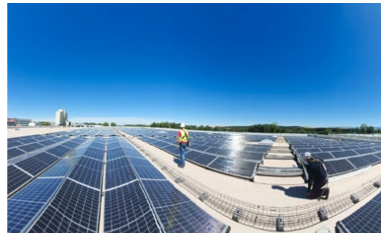
ZONNEPANELEN OP HET DAK VAN DE ONTEX- FABRIEK IN SEGOVIA, SPANJE.
