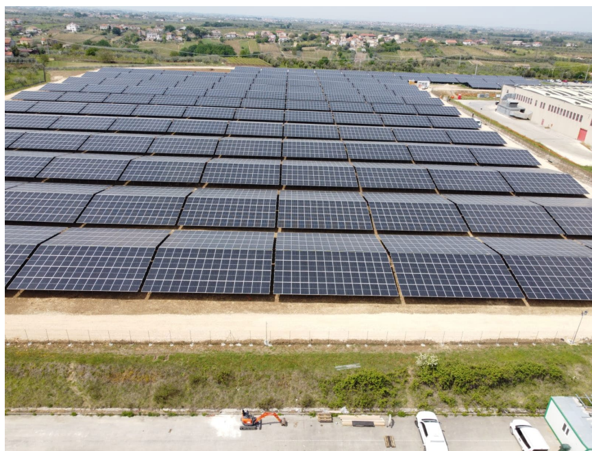
Nuovo impianto solare di Ontex presso lo stabilimento di Ortona, Italia
